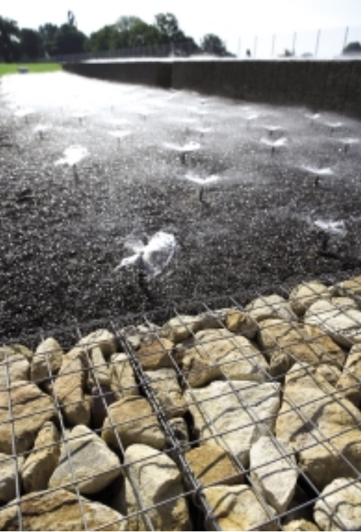
Verteilerdüsen verregnen das Wasser auf dem Filter (Typ Neptun)
